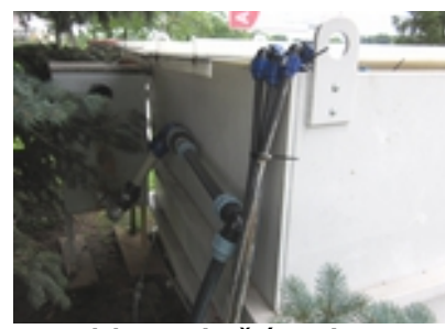
dekontaminační stanice – předčišťování vod
